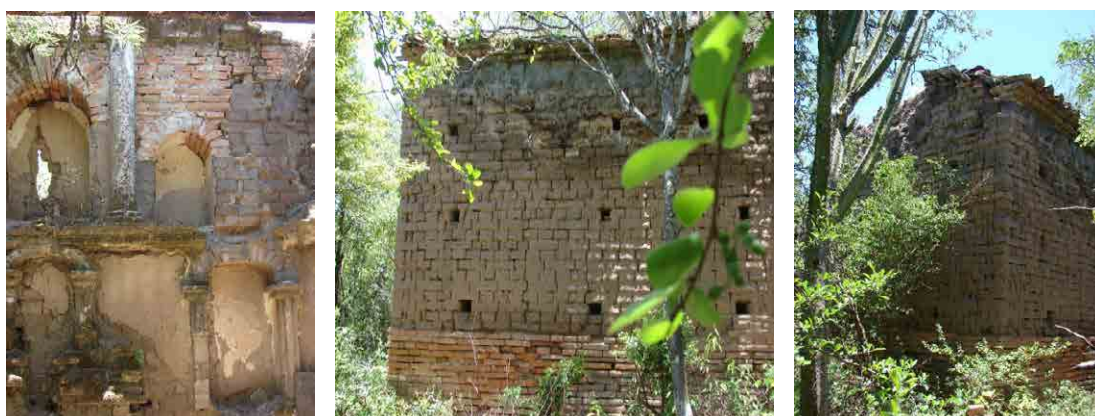
Figuras 10. (de izquierda a derecha) Vista del retablo con sus hornacinas, del muro exterior y encuentros de muros con un sector de la cubierta de tejas (Fotografías de Santoni, M).
